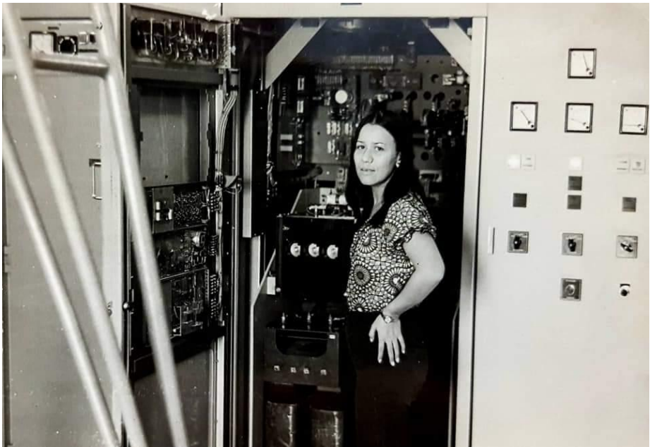
Na foto acima, vemos Joana, XTAL de Nicolau Morozoff, posando ao lado de um painel controlador de grupo gerador.
