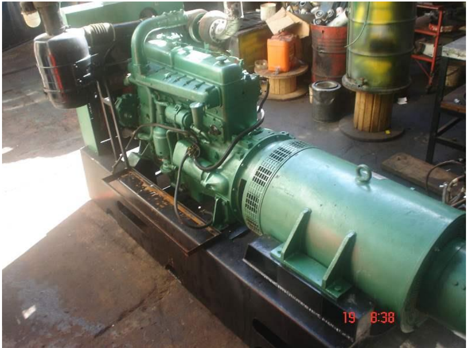
Grupo gerador Scania DS11
