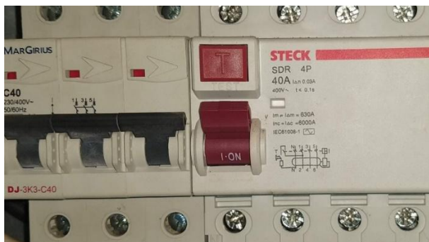
Figura 3. Um interruptor diferencial-residual, de proteção contra correntes de fugas (Steck, à direita), tetrapolar (3P + N), acoplado a um disjuntor trifásico para atuação contra curtos-circuitos e/ou sobrecargas (MarGirius, à esquerda). Os dispositivos diferenciais-residuais possuem um botão de teste, marcado "T", que deve ser acionado semestralmente (ou em intervalos menores), para verificação do funcionamento.
